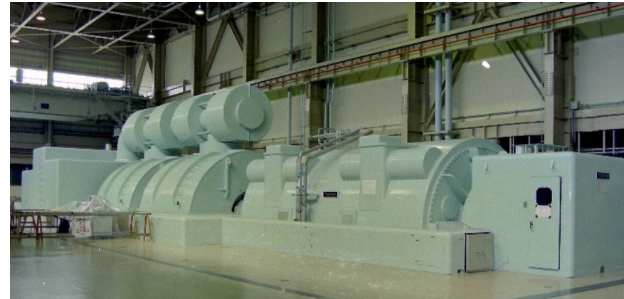
タービン発電機（タービン建物3階）
